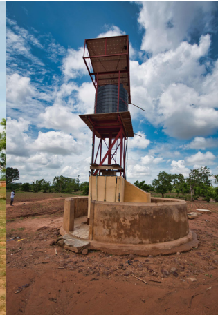
Entretien du château d'eau de Natchabonga
