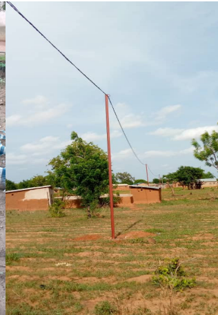
Conexion électrique du bâtiment
