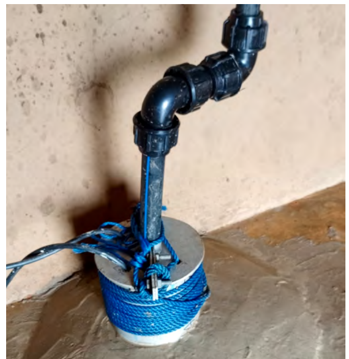
Figure 21 :Tête du forage de Ouicha imperméabilisé
